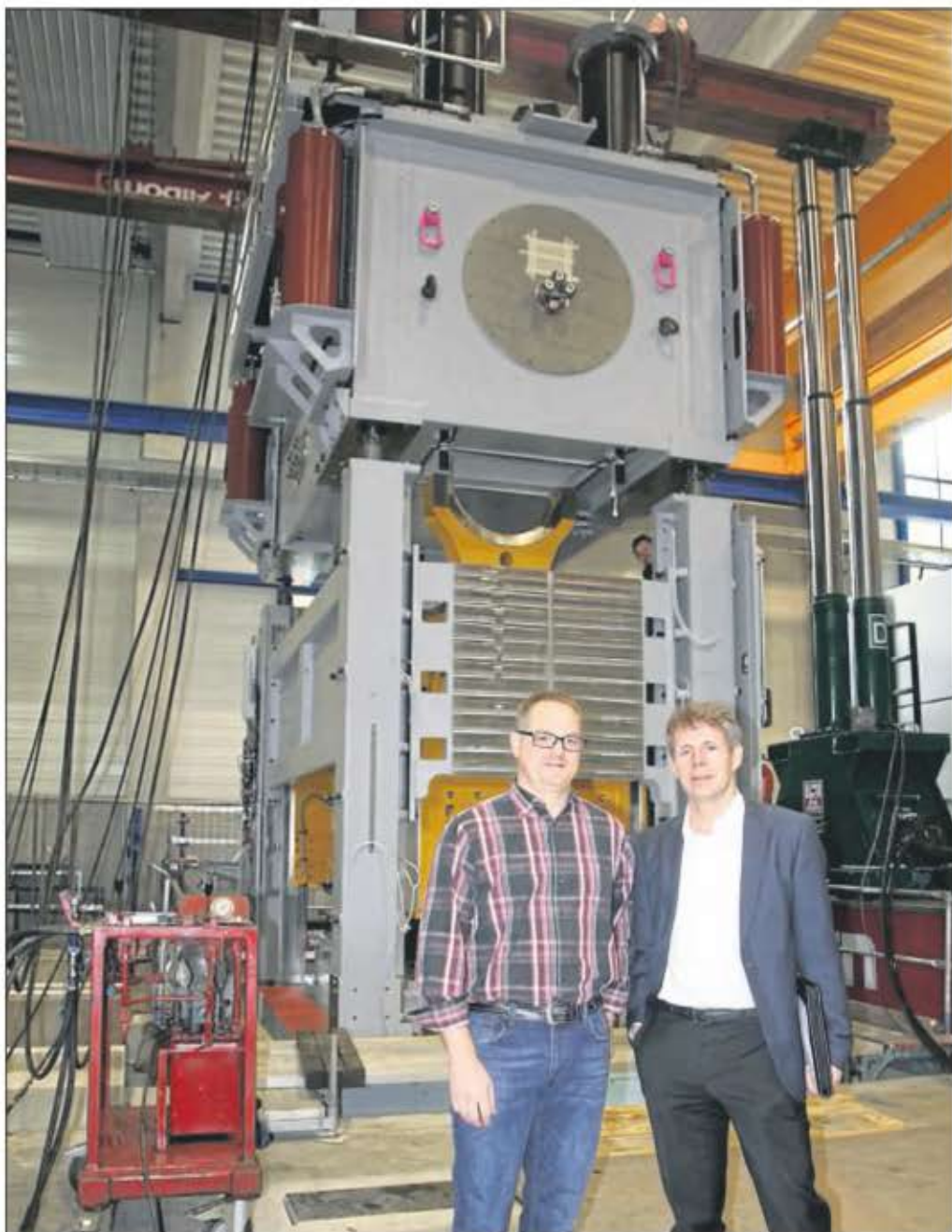
Guido Grüber, Leiter der Instandhaltung (links), und Teckentrup-Geschäftsführer Thomas Volborth (rechts) verfolgten den entscheidenden Moment: Die großen Einzelteile der Transferpresse wurden am Samstagmorgen zusammengebaut. • Foto: Grein
